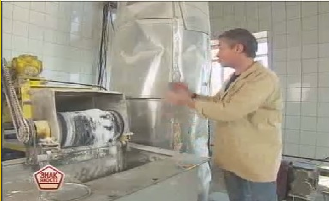
Шнек і сушильна установка
