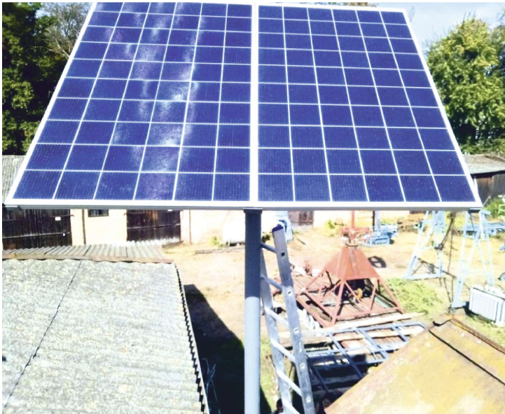
Рис. 1. Фотоелектричні панелі на двохосьовому трекері.
